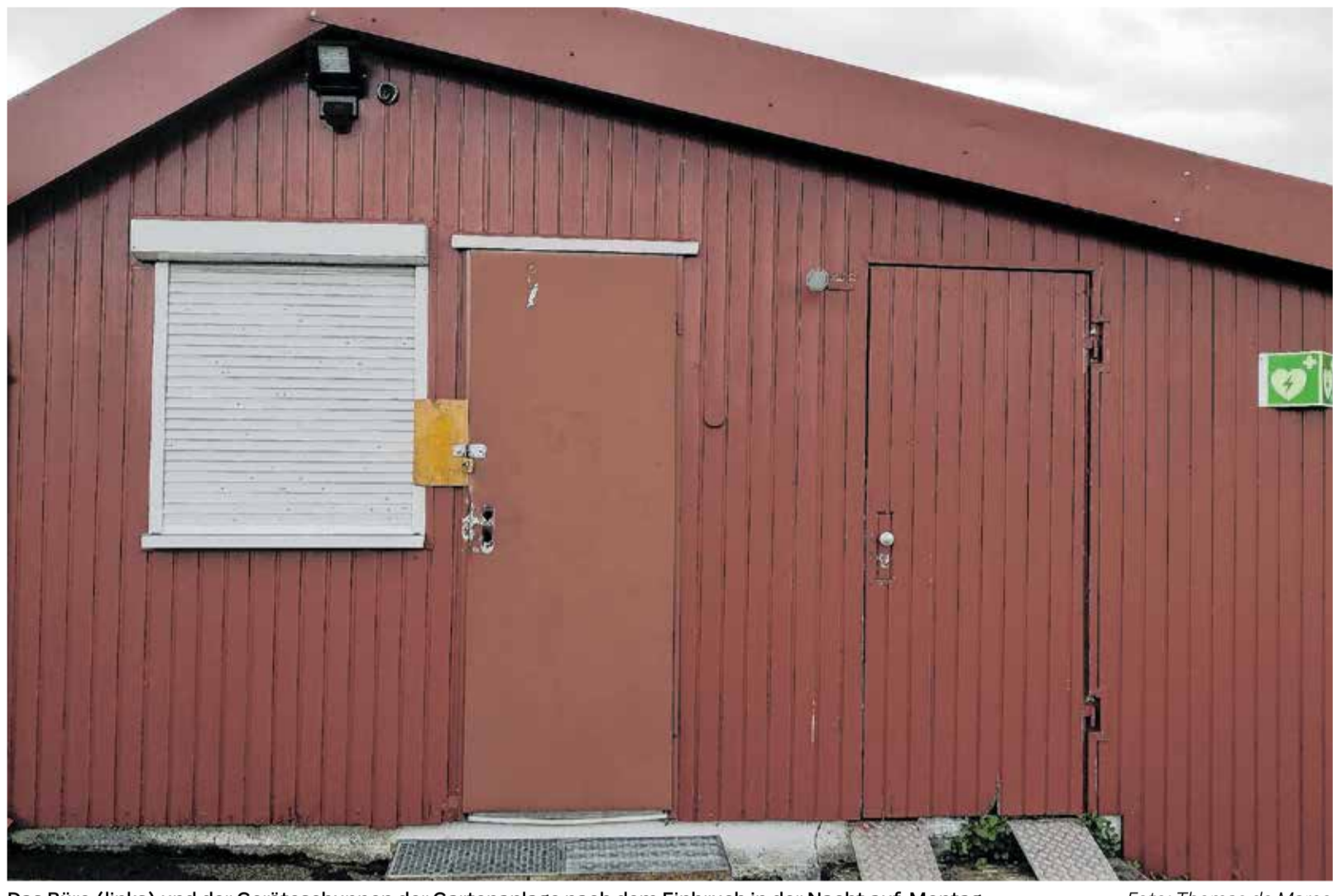
Das Büro (links) und der Geräteschuppen der Gartenanlage nach dem Einbruch in der Nacht auf Montag. Foto: Thomas de Marco
