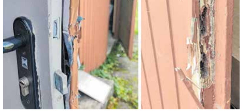
Einbruchsspuren an den Türen des Vereinsheims der Gartenanlage Wackersbronn. Foto: Verein
